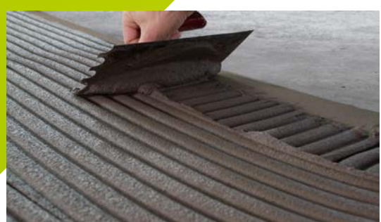
Mit der Glättkelle eine dünne, geschlossene Kontaktschicht auf den Untergrund aufkratzen, frischen Mörtel nachlegen und mit Zahntraufel gleichmäßig aufkämmen
