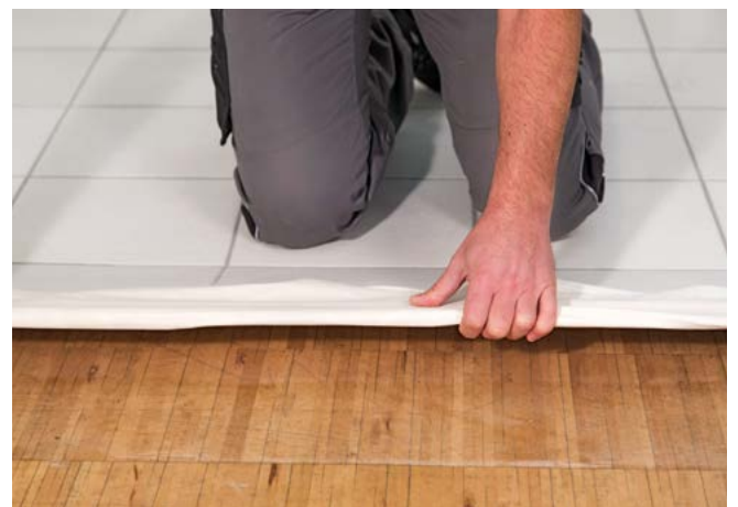
Zugeschnittene codex X-Change-Vliese in die nasse Fixierung einbringen, nach 24 h Belag aufbringen und fachgerecht Fliese und Naturstein aufbringen
